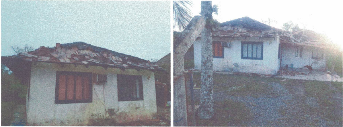
Danos em propriedades particulares no Município de Luiz Alves/SC
